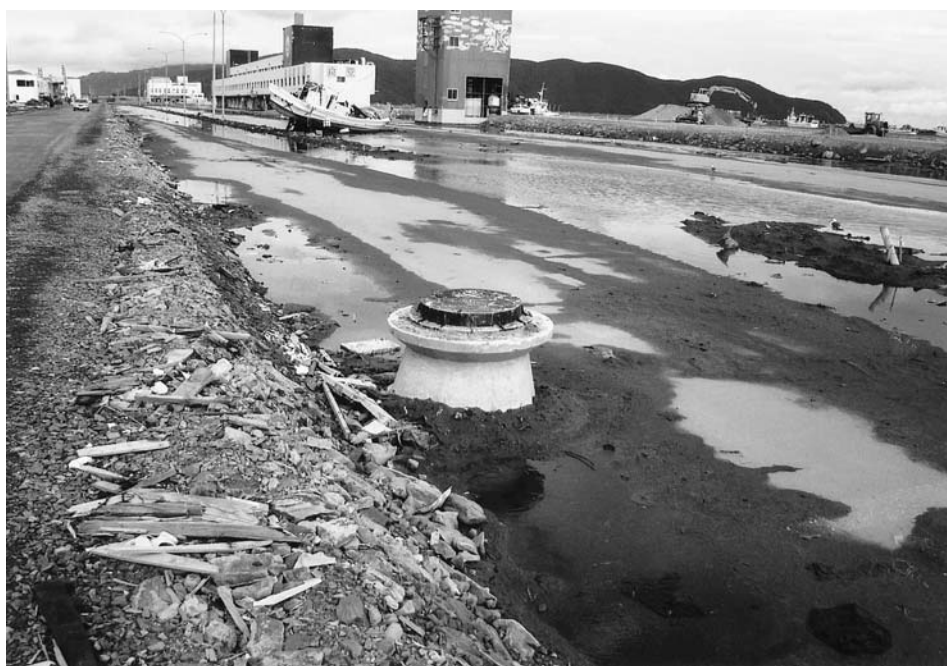
図5 宮城県石巻市魚町。石巻漁港の海岸に並行する道路にできたマンホールの浮き上がり。左端の道路は震災後に沈下した道路上に高さ約30cmの土盛りで作られた。
