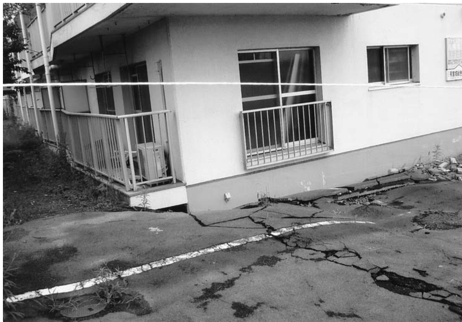
図7 宮城県大崎市古川。液状化により傾いた4階建てアパート。
