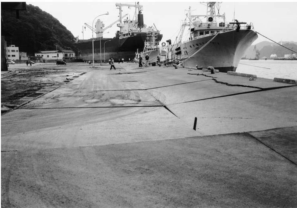
図3 岩手県釜石市釜石港。港内のコンクリート舗装面が液状化により不同沈下を受けて，波打っている。
