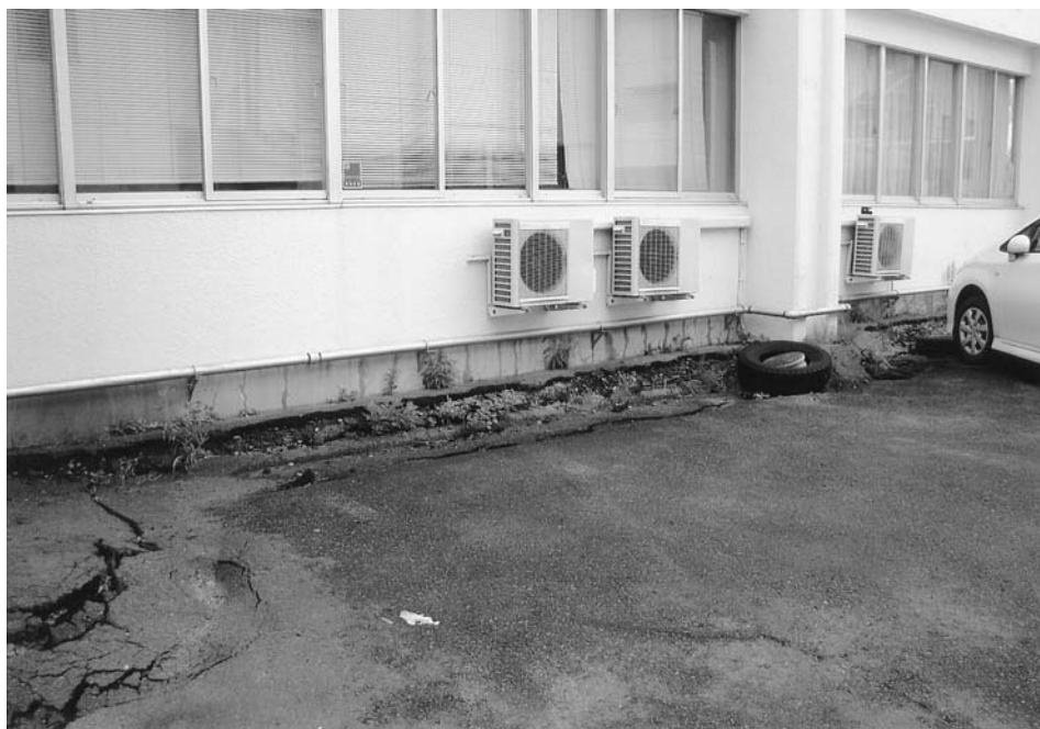
図8 宮城県大崎市古川。建物周辺の液状化により地面が沈下し、建物が抜け上がった。
