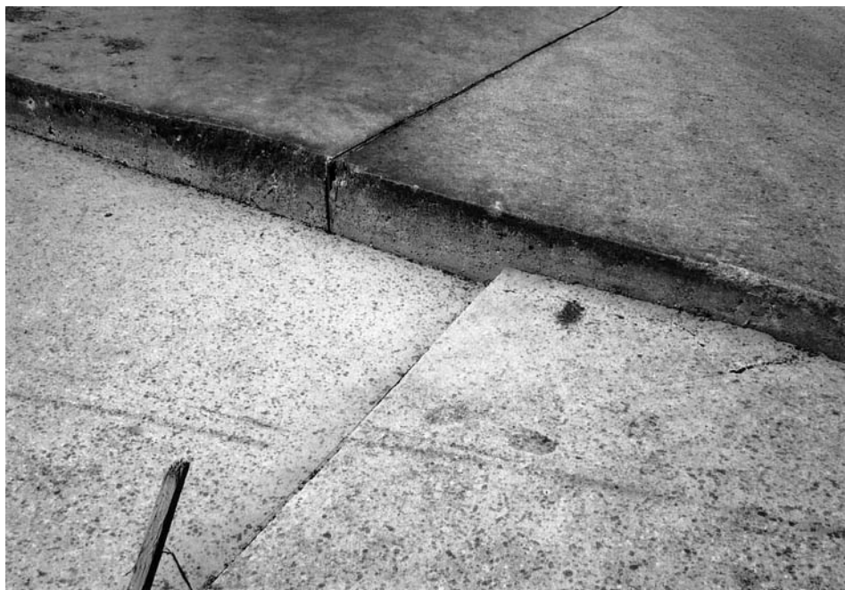
図4 岩手県釜石市釜石港。不同沈下によりコンクリートブロックの接合部に約11cmの段差ができた。
