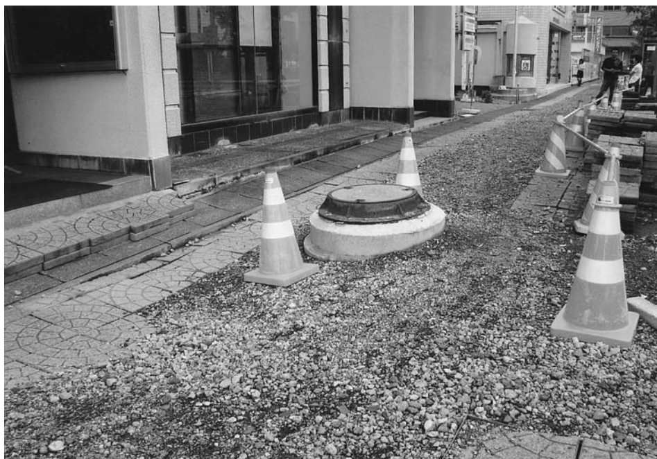
図11 宮城県大崎市古川。古川駅前付近の歩道でマンホールの浮き上がり。下水道建設の位置は沈下し、震災後に碎石で埋められた。
