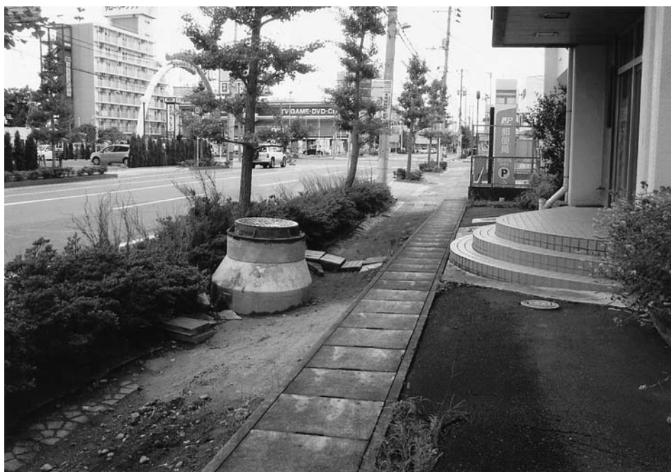
図12 宮城県大崎市古川。古川駅前の最大のマンホールの浮き上がり、高さ約40cm。
