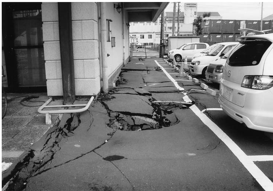
図9 宮城県大崎市古川。古川駅前の農業組合の建物と駐車場の境界。駐車場の液状化によりアスファルト舗装に亀裂が入った。建物と舗装面に段差が生じている。
